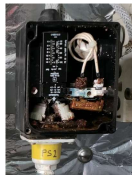
腐食により作動不可
