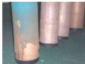
劣化した窒素発生装置フィルタ
