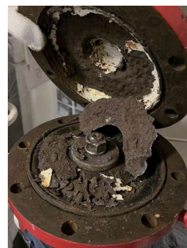
腐食により作動不可
