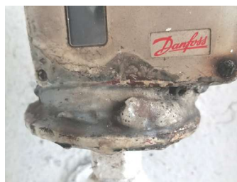
不適切に修理された圧力 SW.
