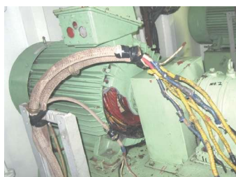
モーター損傷
