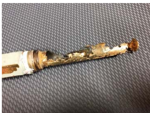
写真－３ 腐食した鞘管 Photo-3 Corroded Sheath Pipe
