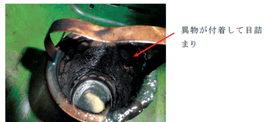
写真2.9-2 こし器①目詰まり状況
