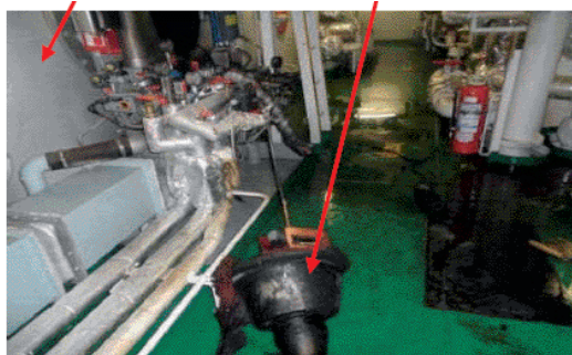
写真2.3-1 バーナユニットドア
